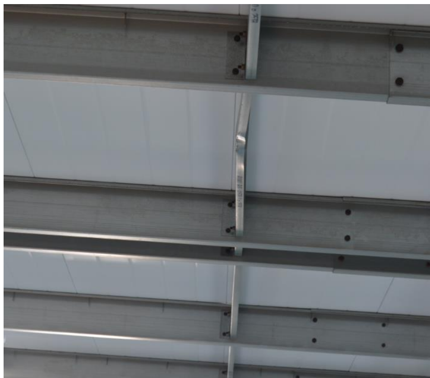
Рис. 3. Потеря устойчивости распоров по покрытию
